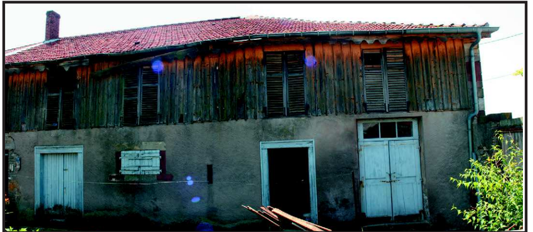
Dépendance latérale à bardage bois et lambrequins à remettre en état
